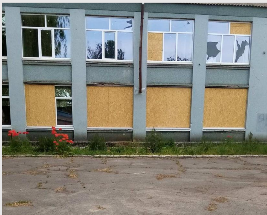
Будинок культури в селі Золота Балка - 70% руйнувань.
